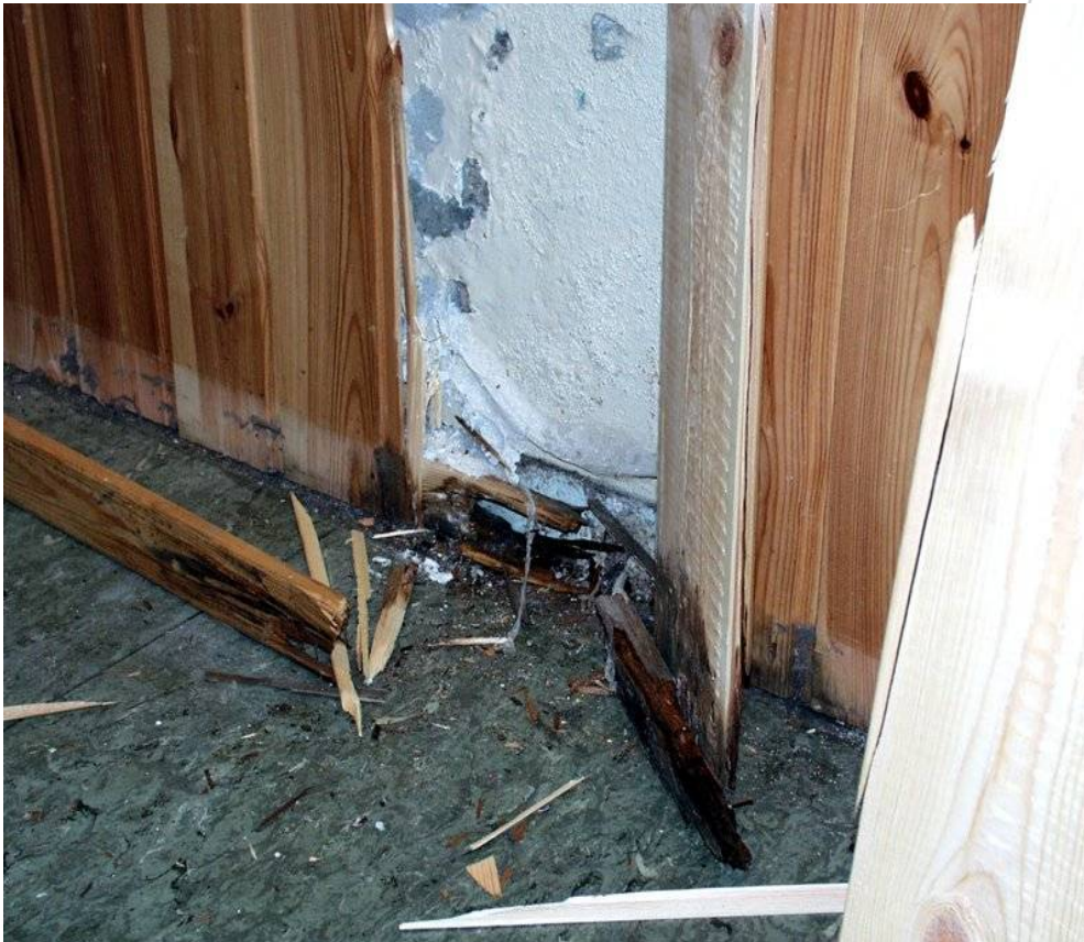
Råte i innvendig kledning
